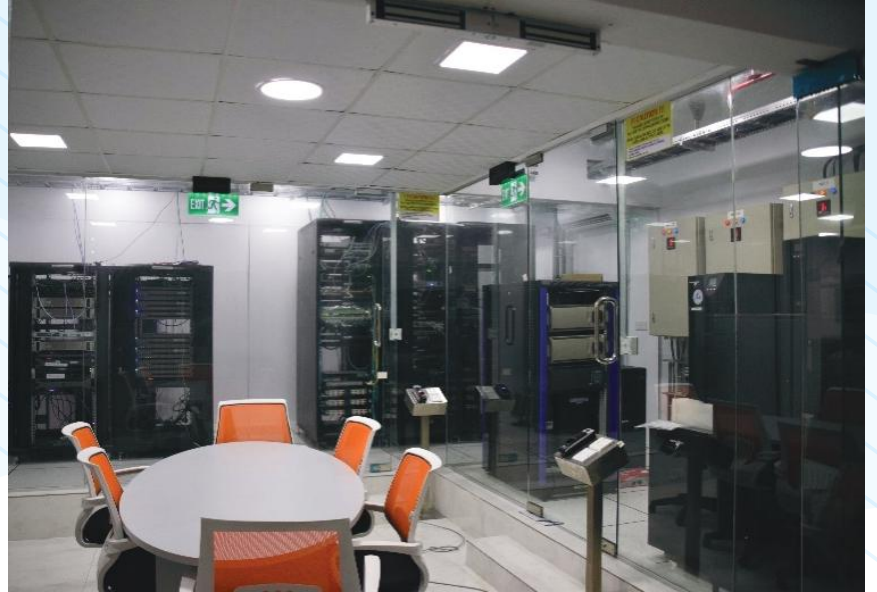
এলজিইডি সদর দপ্তরে নবনির্মিত সার্ভার রুম
