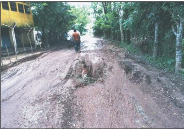
সমাস্তর রক্ষণাবেক্ষণ-পূর্ব তালতলা আর এন্ড এইচ- পায়রা জিসি সড়কের অবস্থা, উপজেলাঃ অভয়নগর, জেলাঃ যশোর।
