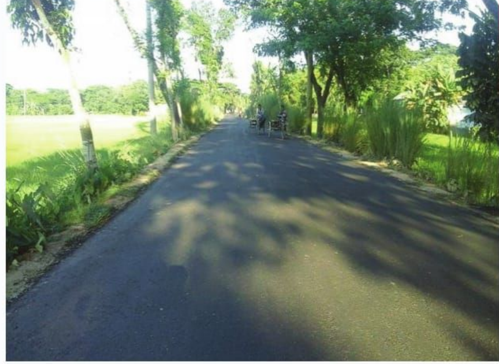
[সিসি দ্বারা রক্ষণাবেক্ষণের পর] টঙ্গী - ইপিজেড (RHD)-নরসিনপুর - কাশিমপুর জিসি সড়ক, উপজেলাঃ সাভার, জেলাঃ ঢাকা।
